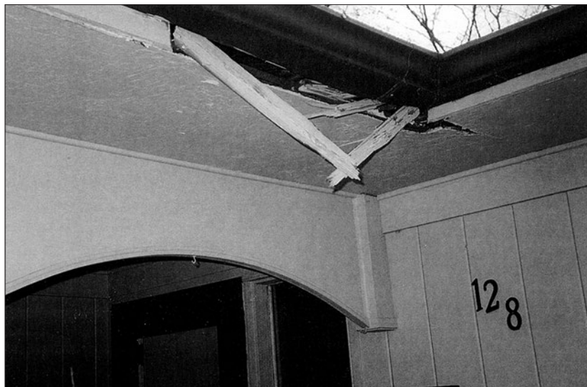
Zniszczenia spowodowane przez okaz Kolkebecka, gdy uderzył on w dach i rynnę. Fot. Joseph Kolkebeck.
