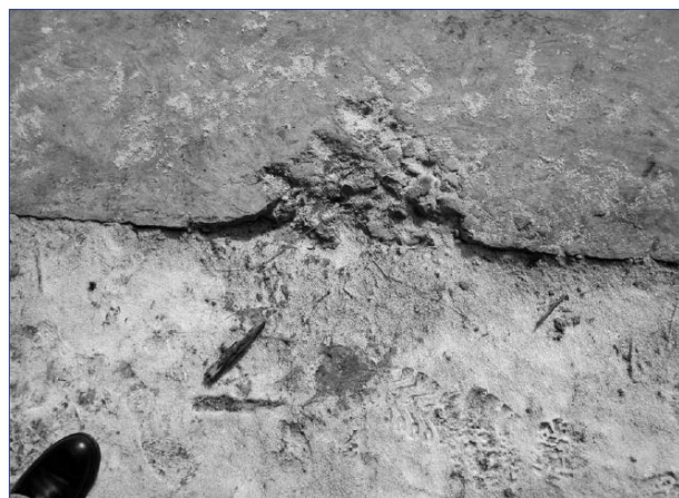
Fot. 2. Siła uderzenia uszkodziła ulicę we wsi Yehong, pozostawiając mały krater uderzeniowy.
