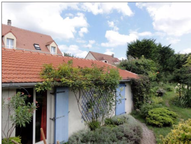
Meteoryt przebił dachówki po prawej stronie tego budynku i zatrzymał się w izolacji z włókna szklanego pod nimi. © Pierre-Marie Pelé, meteor-center.com
